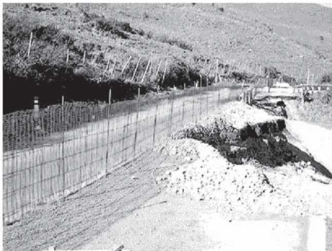
Il tratto di strada della "117" che rischia di crollare per il maltempo
